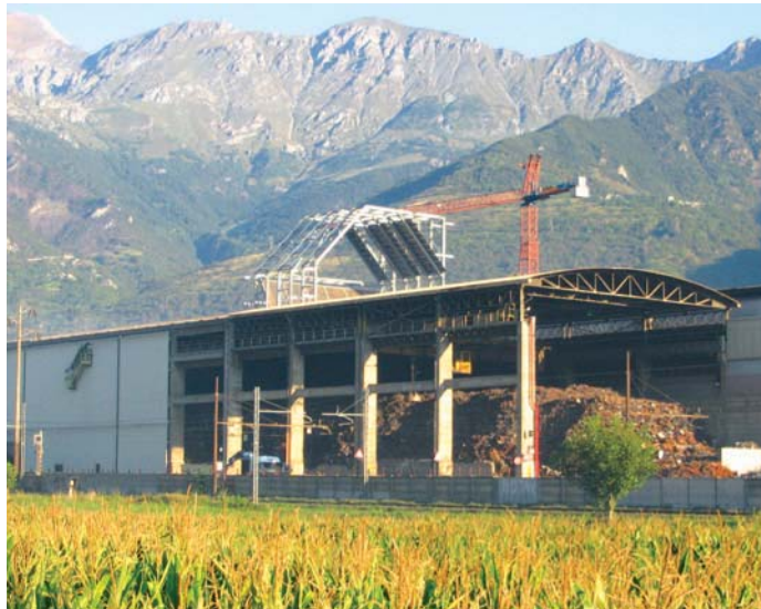
I lavori per la collocazione della nuova cappa nello stabilimento Beltrame di San Didero
