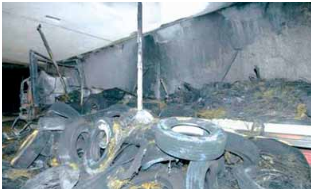
Trafo del Frejus: il camion dei pneumatici che ha provocato l'incendio
